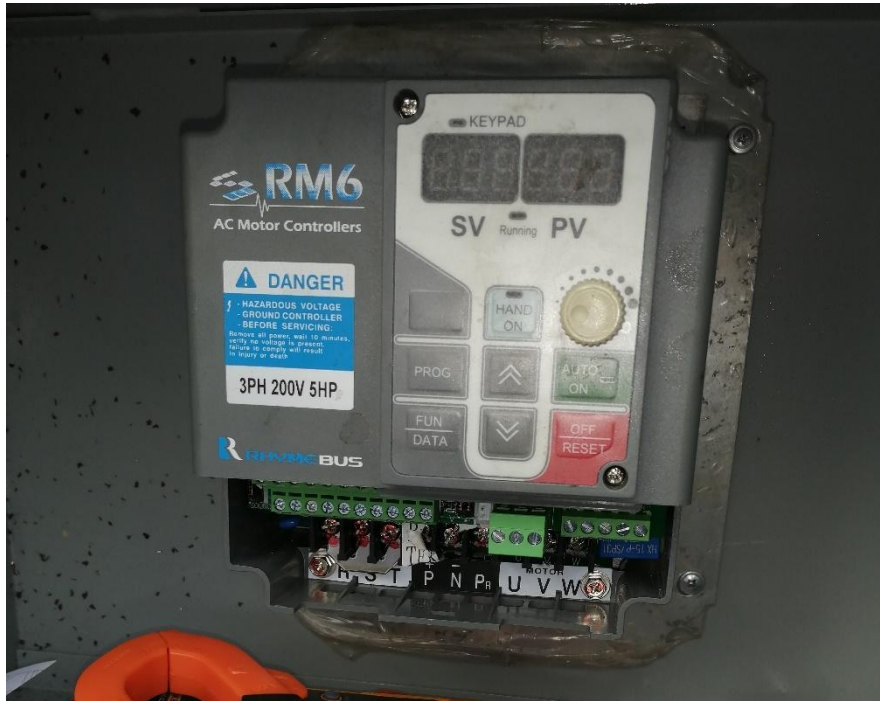
imagen 18 instalación de variador solar
