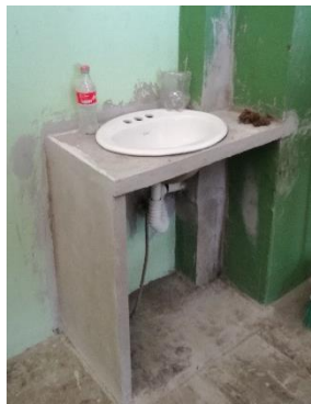
Ilustración 2. Colocación de lavabos de manos intermedios.
