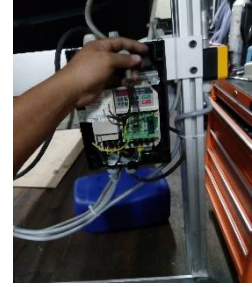
Imagen 16 Conexión a variador.
