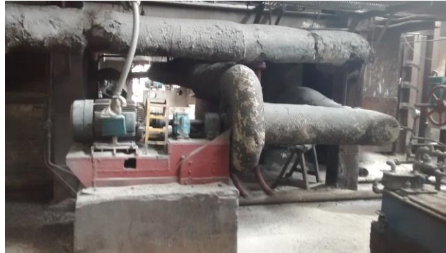
Ilustración 20 Ventilador toberas de la caldera N°12, se aprecian sus conductos, chumaceras y el motor que lo impulsa.
