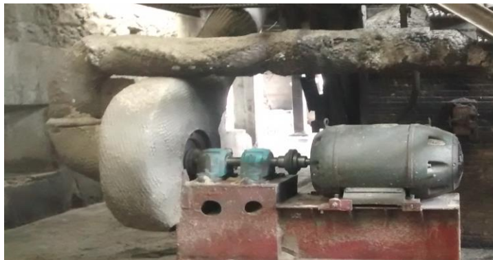
Ilustración 21 Ventilador espaciador con sus chumaceras, flechas, motor, tuberías y la base a la cual está anclado.
