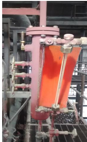
Ilustración 30 Indicador de nivel caldera N°14
