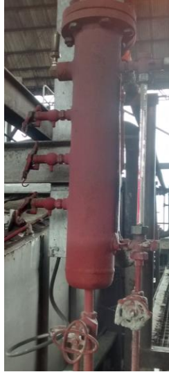
Ilustración 31 Indicador de nivel caldera N°15.
