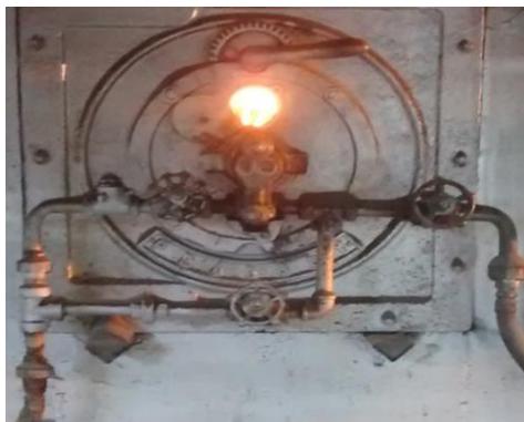
Ilustración 13 Válvulas y colocación de los quemadores.
