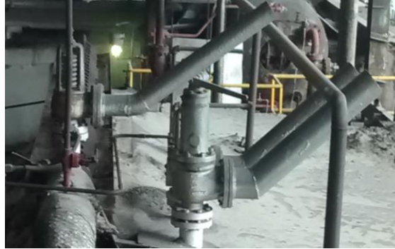
Ilustración 27 Válvulas de seguridad.
