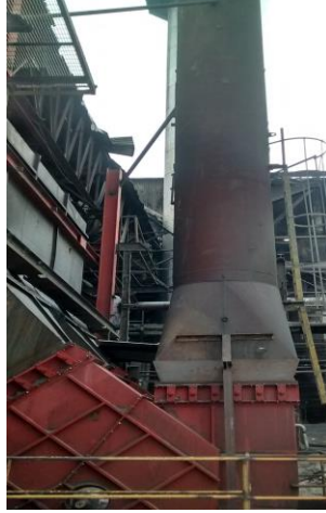
Ilustración 19 Chimenea, las calderas cuentan con orificios cerca de la salida de los gases para realizar muestras de los gases.
