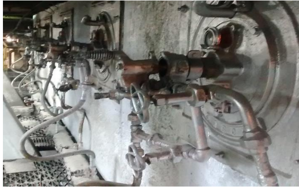
Ilustración 12 Quemadores de combustóleo caldera N°14
