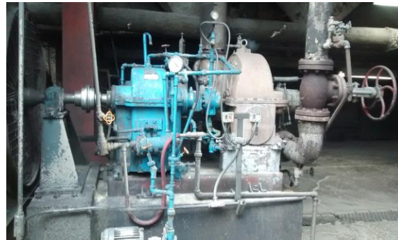
Ilustración 24 Vista lateral ventilador tiro forzado, este ventilador es primordial para el buen funcionamiento de una caldera, se aprecia la flecha de alta velocidad, de baja velocidad, la turbina de vapor y su chumacera lado coplee.
