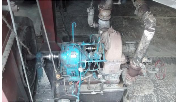
Ilustración 23 vista superior del ventilador tiro forzado de la caldera N°13
