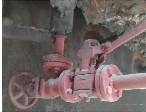
Ilustración 9 Purga de una caldera.
