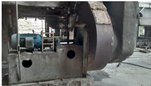
Ilustración 22 Ventilador fluidizado de la caldera N°15.
