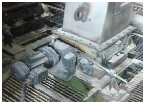
Ilustración 14 Alimentador de bagazo caldera N°13.
