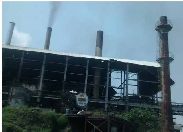
Ilustración 18 Chimeneas de las calderas del área.
