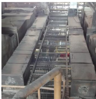
Ilustración 17 Transportador helicoidal calderas N°13 y 14.
