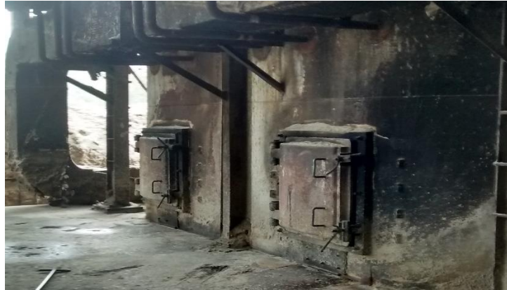
Ilustración 7 Puertas del horno de la caldera N°15.
