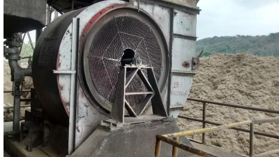
Ilustración 25 Tiro forzado caldera N°15.
