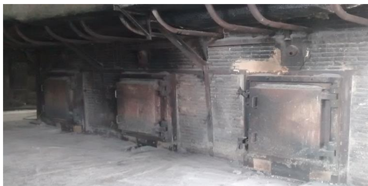
Ilustración 8 Se muestran las puertas de los hornos de la caldera 14, se puede apreciar los compartimentos de los plenum en la parte inferior de las puertas.
