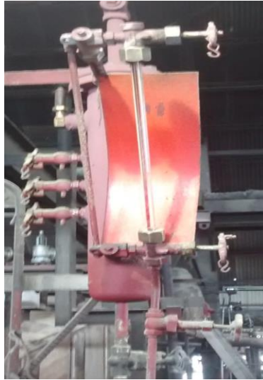
Ilustración 29 Indicador de nivel de las calderas N°13.
