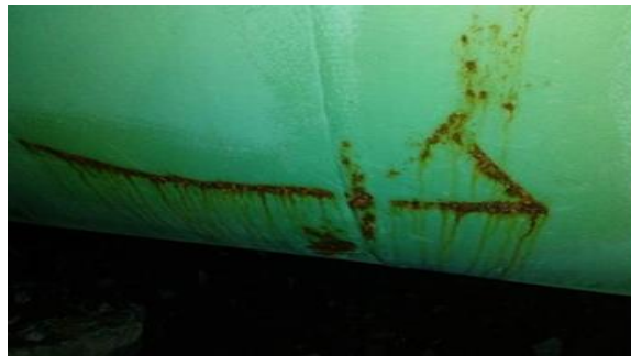
Ilustración 2 Zona de corrosión.
