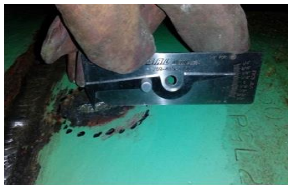
Ilustración 3 Medición de profundidad de los daños encontrados.
