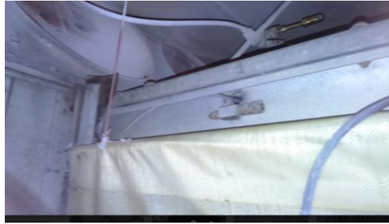
Ilustración 16 Falta manguera al carro
