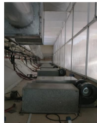
Ilustración 47 Blowers en plenum frío nac.
