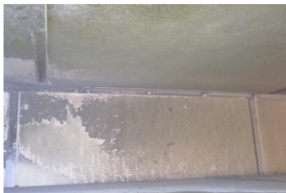
Ilustración 29 Paredes con residuos de salitre, desinfectante y polvo
