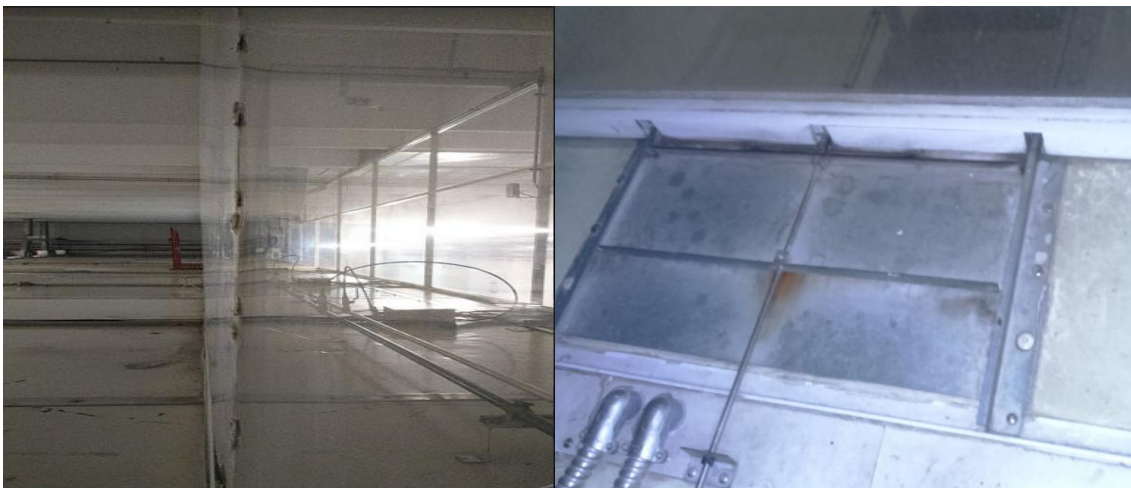
Ilustración 19 Los acrílicos se inflan por demasiado aire frío y el dámper se cierra
