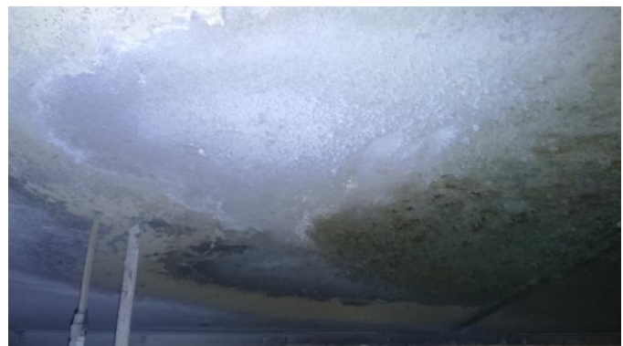
Ilustración 28 Techo con presencia de salitre
