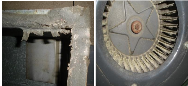
Ilustración 49. Blowers sucios y sin poliuretano
