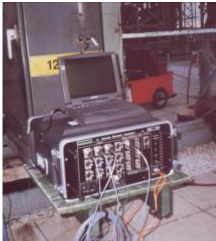
Figura 3.4 Equipo de medidor de sincronismo y tiempos de operación
