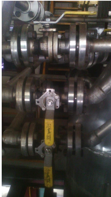
Imagen 3.8(válvulas de flujo de producto, vapor y flujo de agua)
