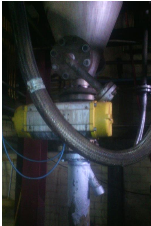
Imagen 3.6 ( válvula de descarga )
