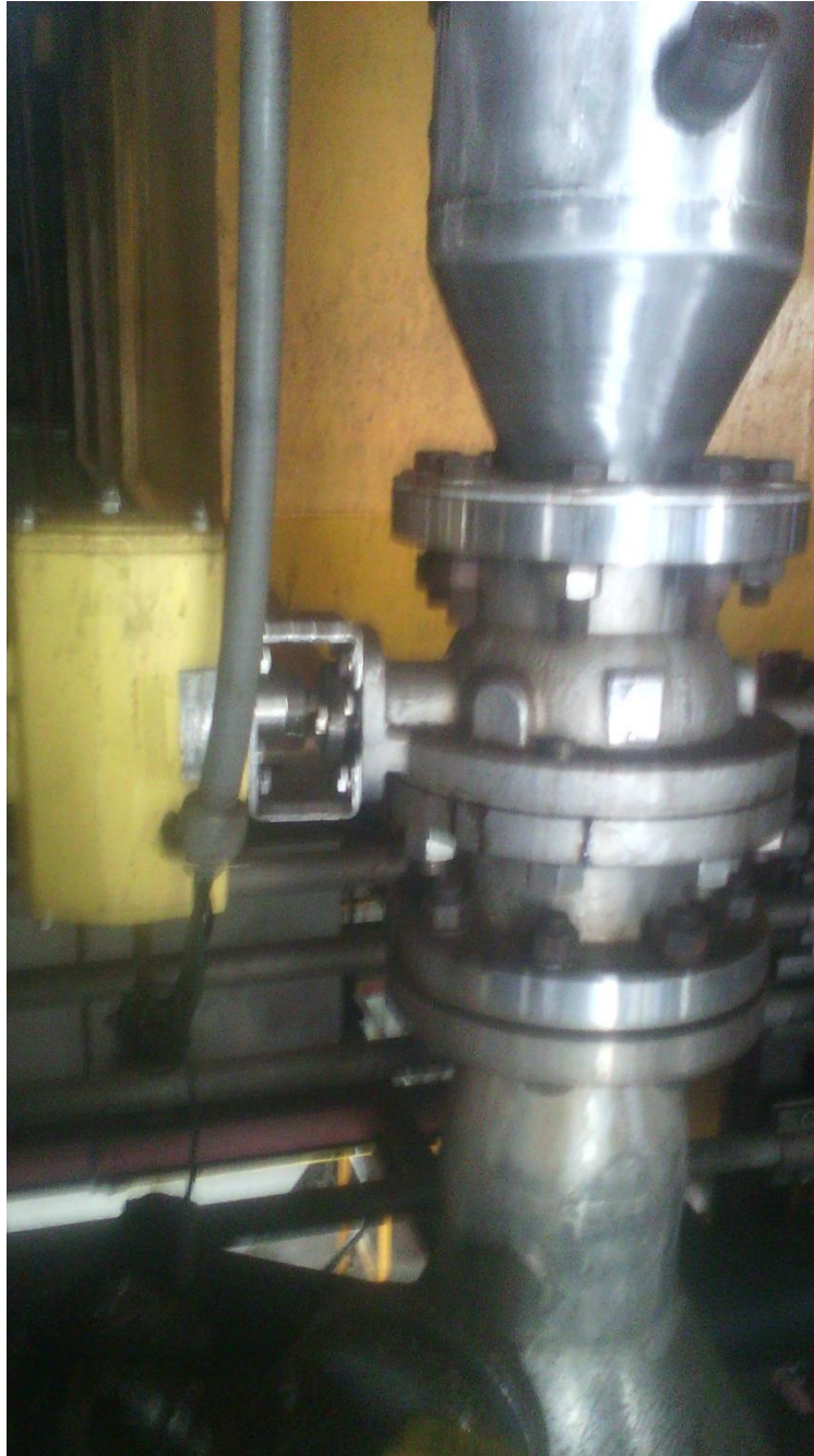
Imagen 3.7 válvula de carga
