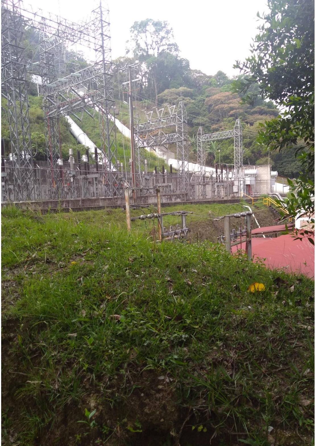
Anexo 11. Instalaciones (Tuberías) (Fuente: PROENERMEX S.A. de C.V.)
