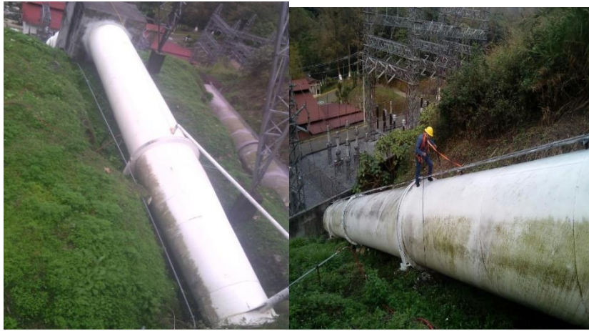
Figura 17. Tuberías forzadas a presión (Fuente: PROENERMEX S.A. de C.V.)
