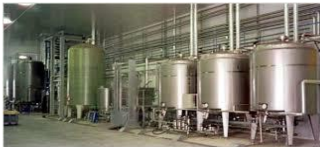
Figura 23. Tanques de grasa.
