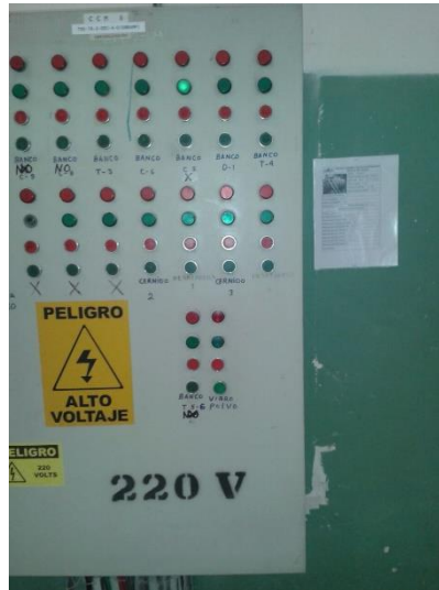
Imagen 18 Colocación de fichas técnicas en Tablero de Control de equipos
