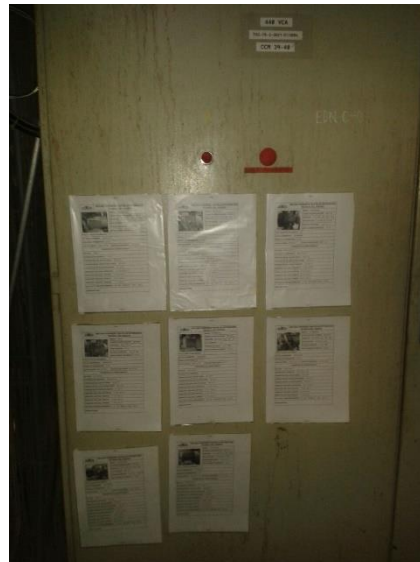
Imagen 19 Colocación de fichas técnicas en Tablero de Control de equipos
