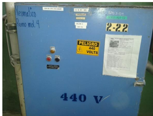
Imagen 16 Colocación de fichas técnicas en Tablero de Control de equipos
