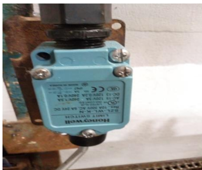
Ilustración 45 Interruptor de rodillo de la cadena transportadora.
