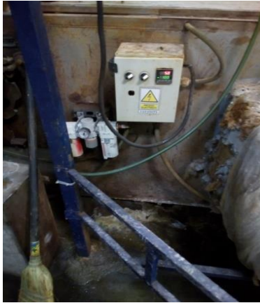
Ilustración 39 unidad de mantenimiento de la secadora.
