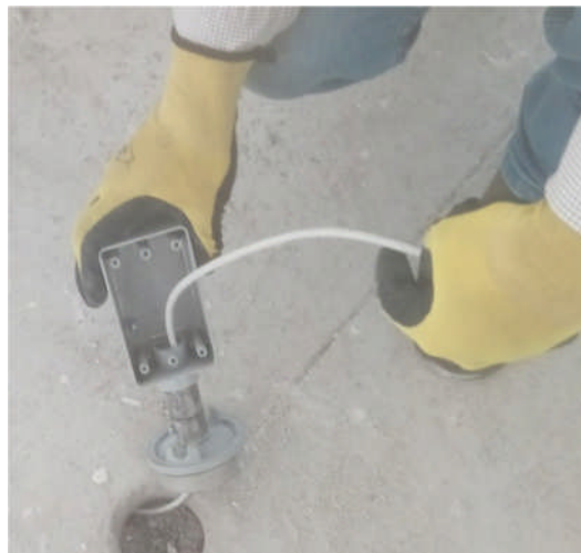
Fig. 3.4 Cableado de nodos
