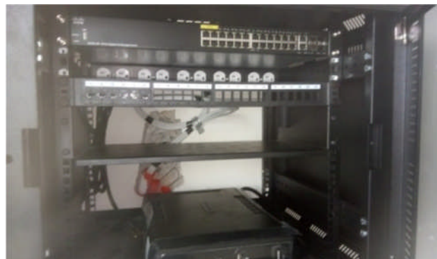
Fig.3.5 Gabinete con equipo instalado
