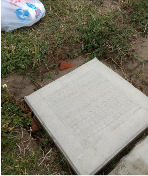
Ilustración 7 Canaleta de concreto del cableado
