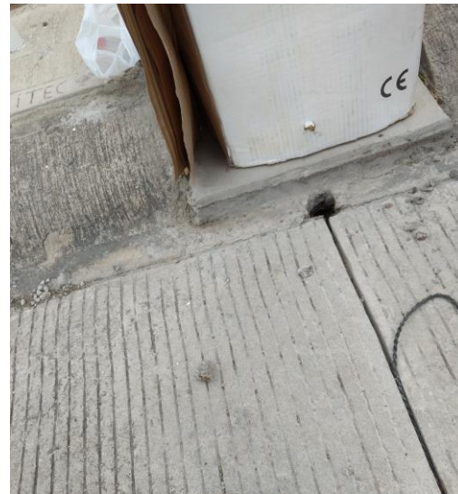
Ilustración 10 Instalación de Lazo con barrera
