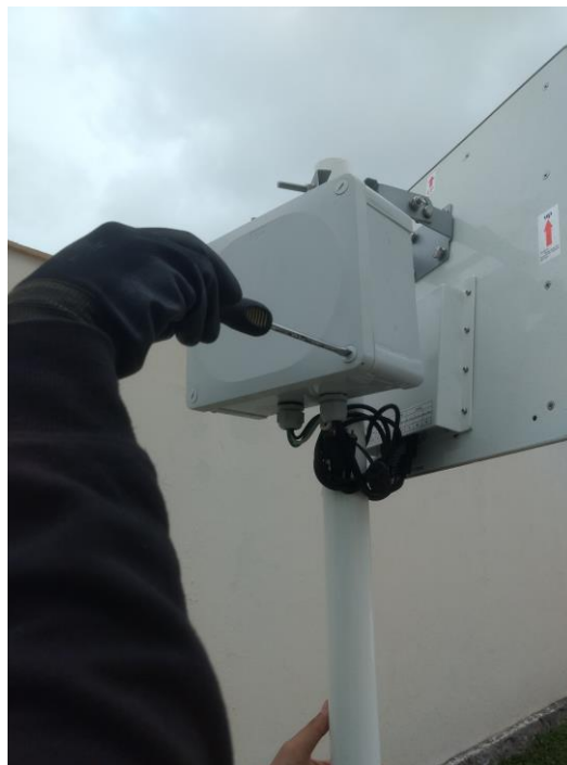
Ilustración 24 Sellado de caja de cables de la antena RFID
