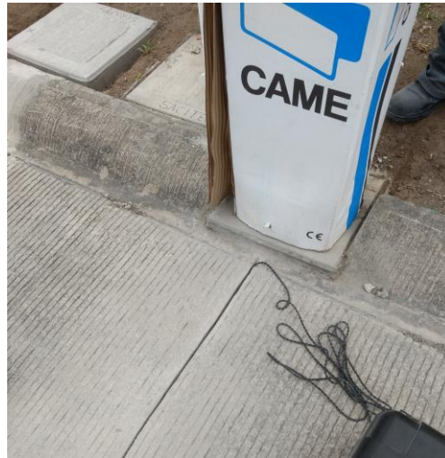
Ilustración 9 Ajustes del cableado de luz y antena RFID con la barrera
