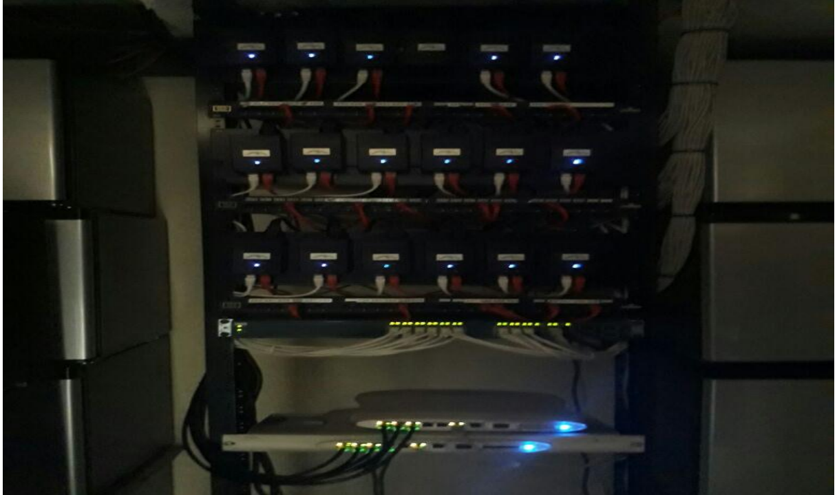
Fig 3. 6 Distribución patch panel
