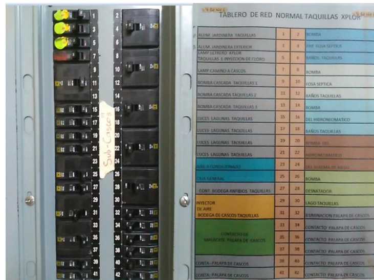
Ilustración 14 Ejemplo de tablero con etiquetas nuevas.
