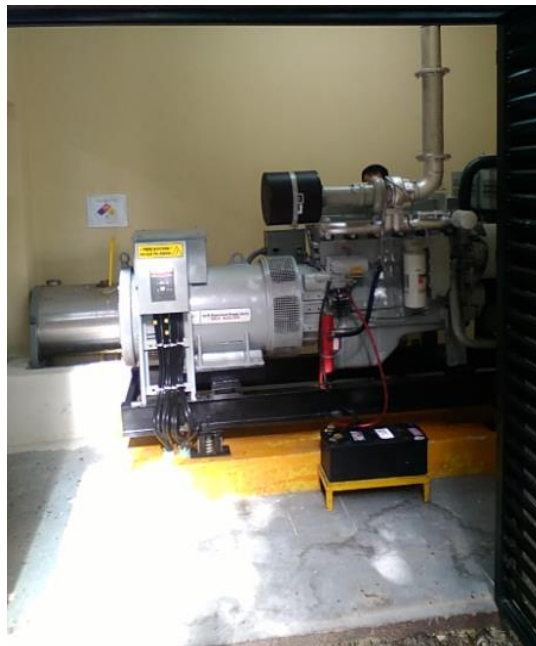
Ilustración 8 Fotografía de un generador de emergencia
