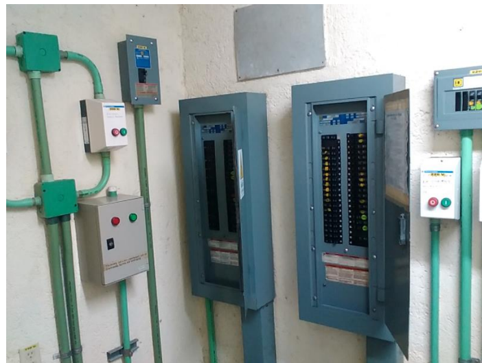
Ilustración 10 Tableros dentro de sub estación.
