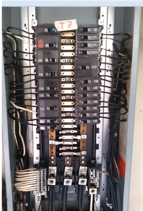
Ilustración 12 Identificación de conductores y breaks.
