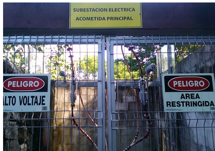
Ilustración 6 Fotografía de acometida principal
