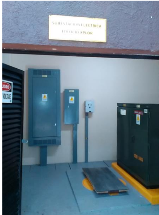
Ilustración 7 Fotografía de una sub estación
