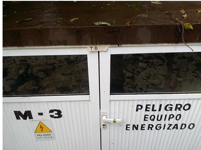
Ilustración 9 Fotografía de murete de media tensión.
