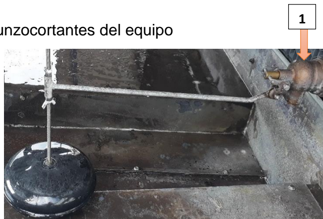
Ilustración 59 Flotador de torre de enfriamiento
