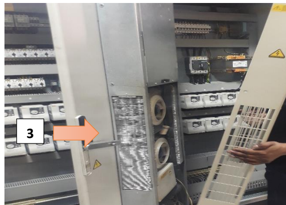
Ilustración 98 Armario eléctrico abierto
