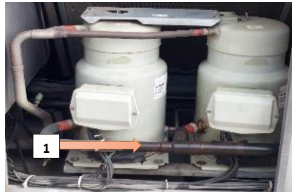
Ilustración 30 compresor chiller trane
