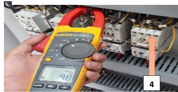
Ilustración 28 toma de lecturas de amperaje
