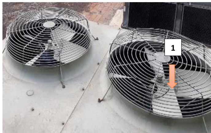
Ilustración 39 ventiladores No. 1 y 2
