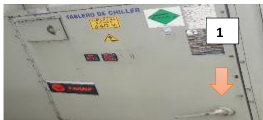
Ilustración 44 Compuerta de armario eléctrico chiller
