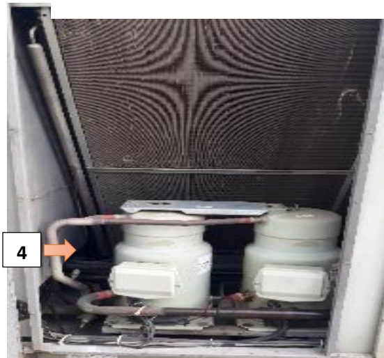
Ilustración 33 Protección de compresores
