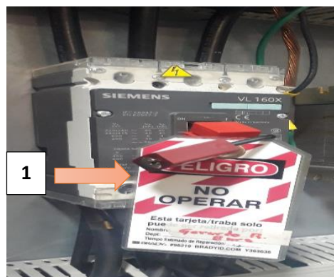
Ilustración 85 Interruptor principal armario eléctrico
