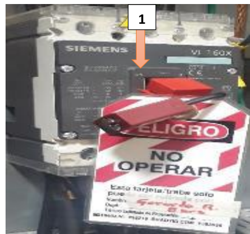
Ilustración 20 interruptor principal bombas
