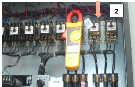
Ilustración 48 Contadores de ventiladores
