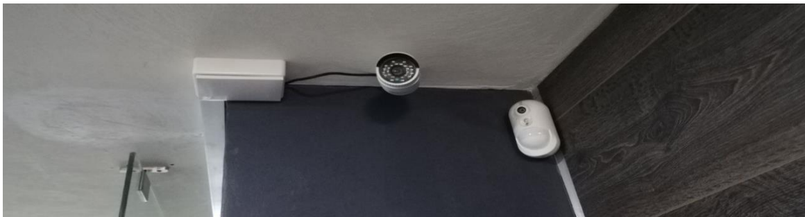
ILUSTRACIÓN 24 CAMARA DE SEGURIDAD
