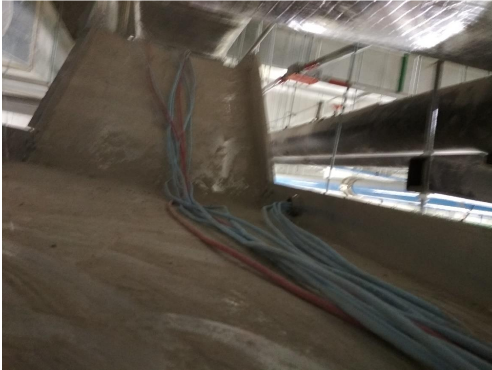
Ilustración 8 Cables tendidos en charola horizontal
