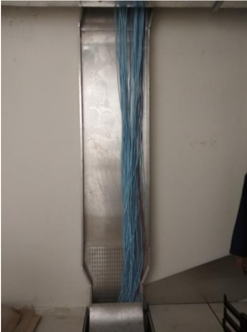
Ilustración 4 Cableado en charola vertical
