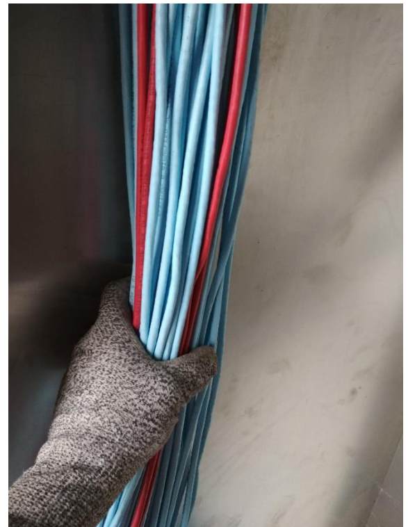
Ilustración 2 Cables de Datos y de CCTV
