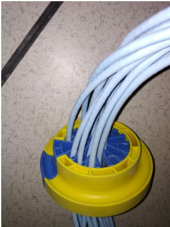
Ilustración 1 Cables en peineta
