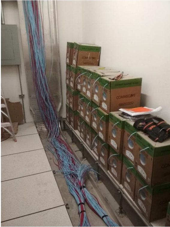
Ilustración 7 Tendido de cable debajo del piso del IDF
