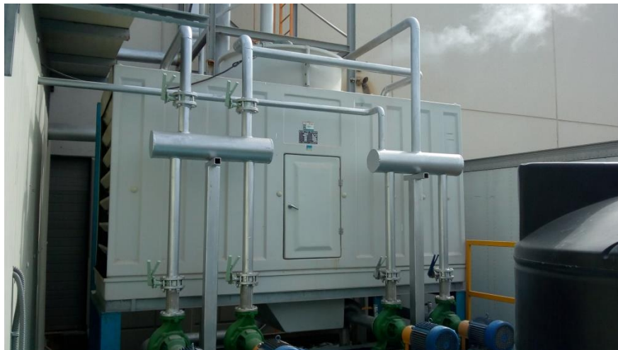
Figura 7. Torre de enfriamiento.
