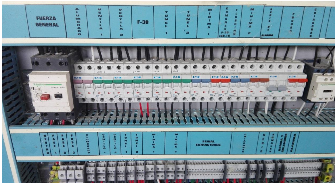
Ilustración 11 Tablero de Control
