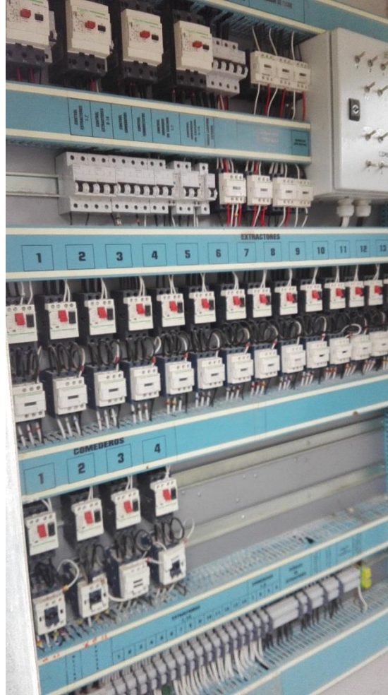
Ilustración 10 Tablero de Control
