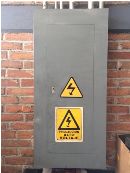
Ilustración 35 Señal de Precaución "Alto Voltaje"
