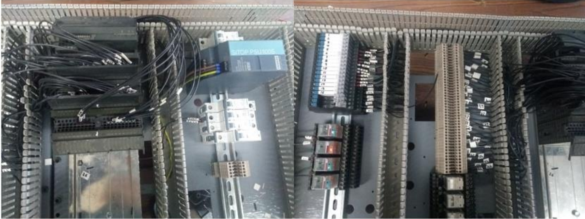
Figura 28. Conexión de módulos
