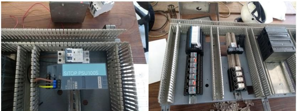
Figura 27. Montaje de fuente y relés
