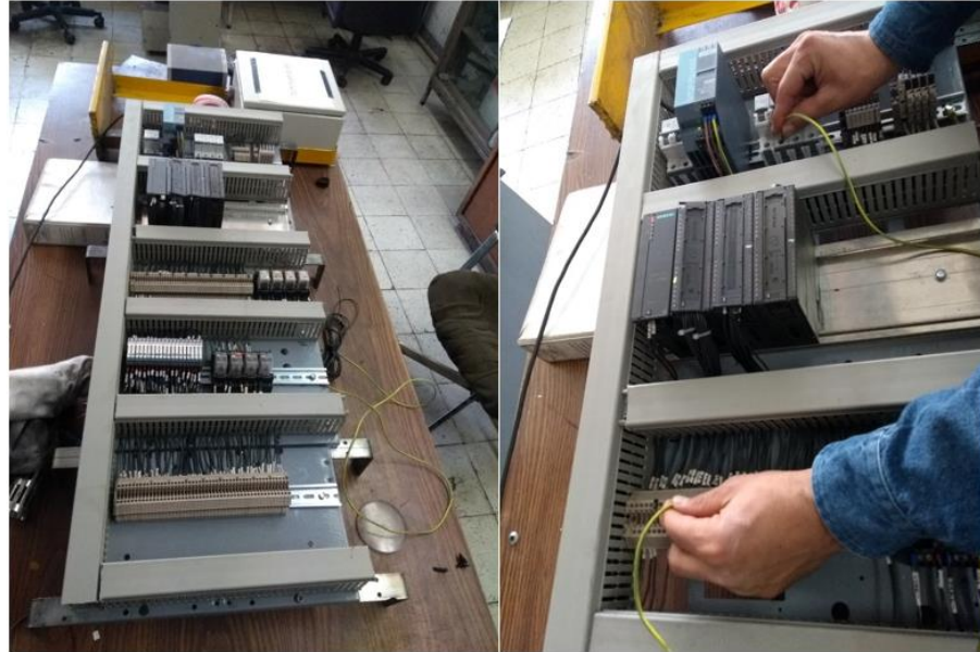
Figura 32. Prueba de funcionamiento
